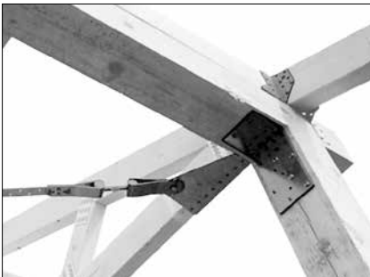
Detail am Traufpunkt: Bandanschluss BNF mit Spanngerät BNSPxxB. Von unten in Deckenebene.
